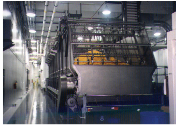
Instalacion de sistemas de gran capacidad
